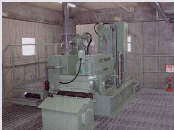
▲汚泥処理棟に据え付けられている脱水機
