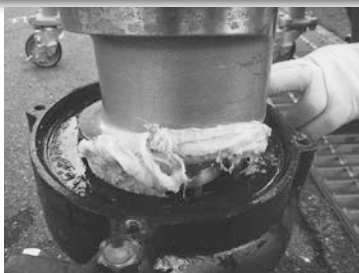
マンホールポンプに絡まったお掃除シート
