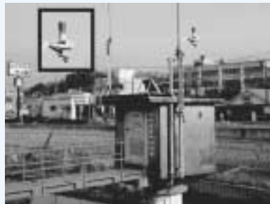
川の警告灯（埋津橋）
