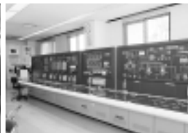
中央操作室 送水ポンプや送風機の運転状況などを24時間施設内の管理をしています
