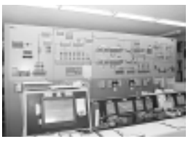
遠隔監視装置 送水ポンプなどの運転状況や、各配水池の水位の確認などを24時間体制で監視しています
