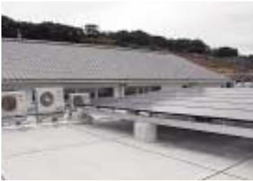
太陽光発電システム
