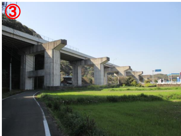
③ 橋梁下部工の現状 (下大渡野町)
