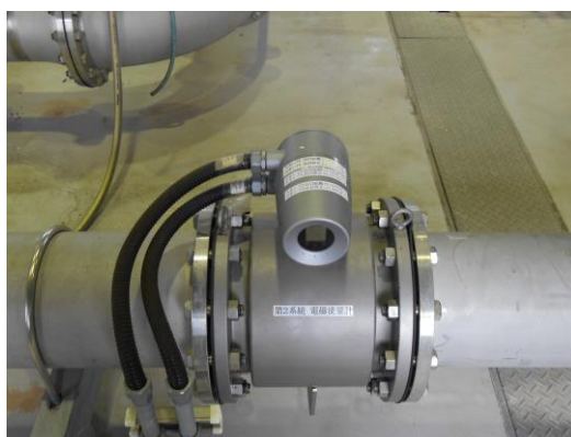
電磁流量計設置状況
