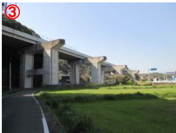
③ 橋梁下部工の現状 (下大渡野町)
