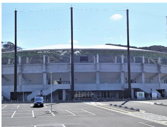
対塩害塗装をしたメインスタンド (スポーツパークいさはや第1野球場)
