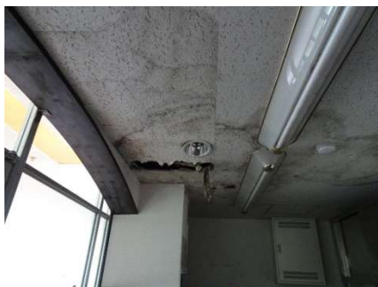
(山茶花高原総合案内センター天井漏水)
