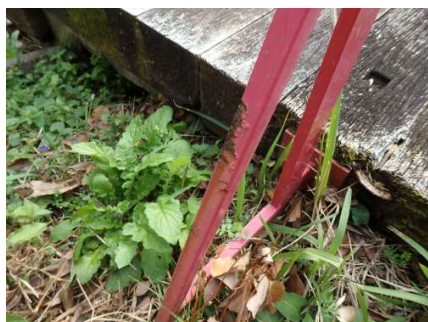
(白木峰高原手摺り 7 一部腐食)
