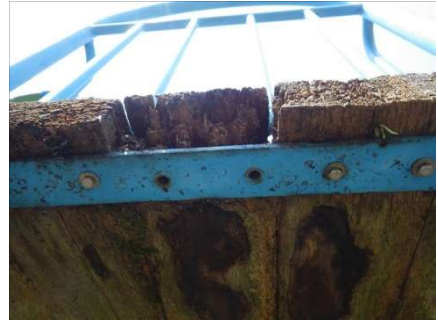
(山道公園滑り台ボルト欠損)
