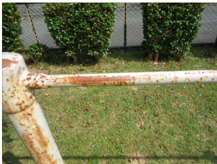
(馬渡町第 1 開発公園 2 連鉄棒腐食)
