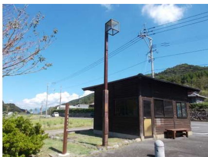
(宗方公園照明灯 5 発錆)
