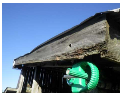
(白木峰高原直売所破風板腐朽)
