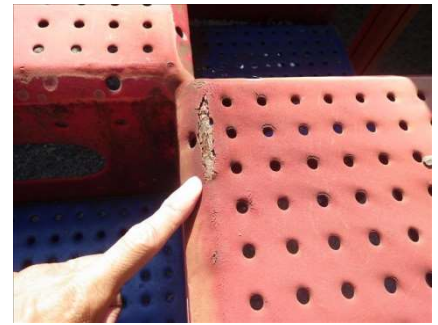
(山茶花高原複合遊具踏板腐食)
