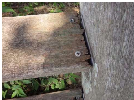
(小江公園複合遊具踏板腐食)
