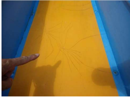
(中里第2公園滑り台滑降部破損)
