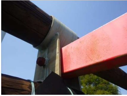
(山茶花高原ターザンロープ金具腐食)
