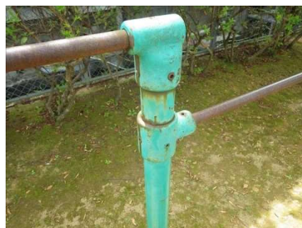
(福井田公園 3 連鉄棒塗装劣化)
