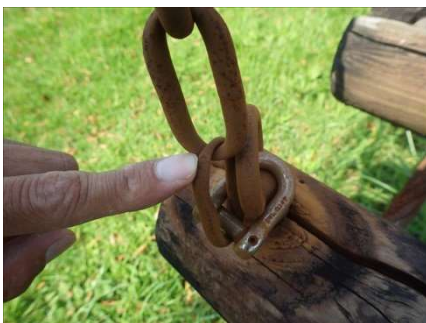
(山茶花高原吊り橋チェーン摩耗)
