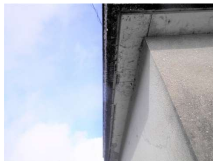
(山茶花高原水道林ノ°室 2 軒先 RC 爆裂)
