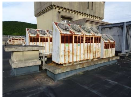
(山茶花高原香りの館室外機発錆)
