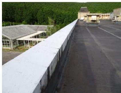
(山茶花高原香りの館ハ°ラ°ットひび割れ)
