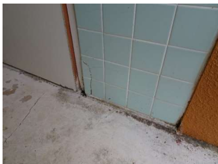
(白木峰高原便所 3 タイル割れ)
