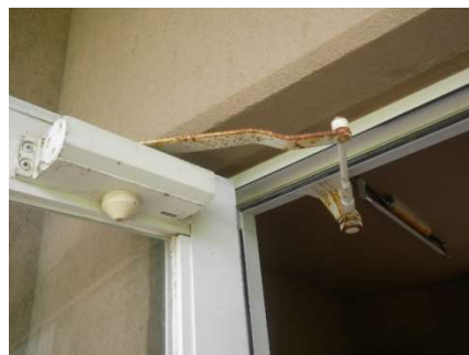
(山茶花高原航空機館建具発錆)
