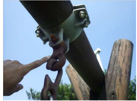
(山茶花高原 2 連ブランコ吊金具腐食)
