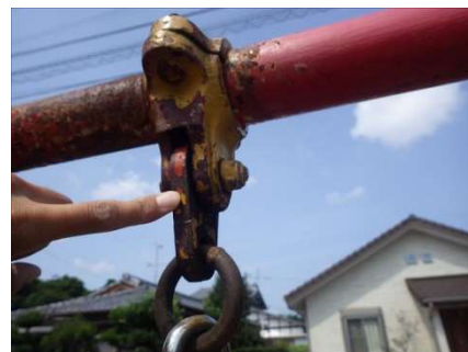
(小船越児童遊園フック吊金具腐食)
