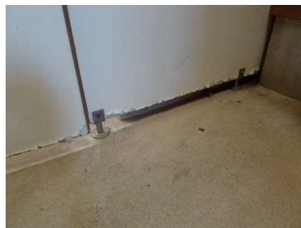
(白木峰高原便所 2 トイレブース劣化)
