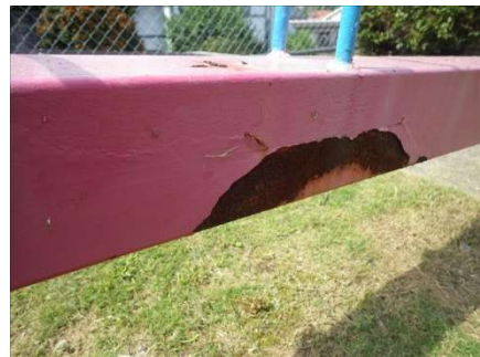
(西栄田町こどものあそびばシーソー腐食)
