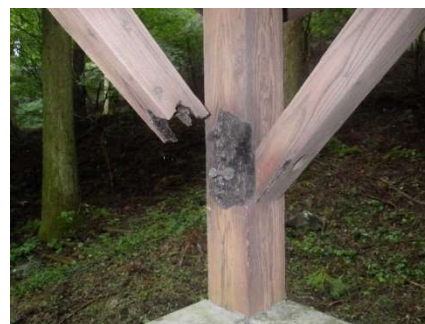
(宗方公園炊飯棟木構造欠損)
