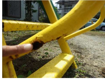
(中里第1公園2方向滑り台登行部腐食)
