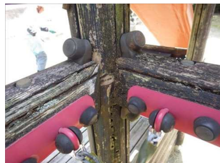
(三部吉公園複合遊具梁部腐食)
