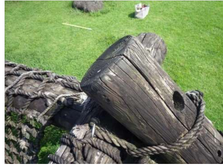
(山茶花高原ネットクライム支柱腐食)
