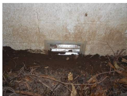
(山茶花高原給水施設外壁開口不良)
