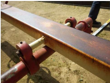
(真崎町第 4 開発公園シーソー腐食)
