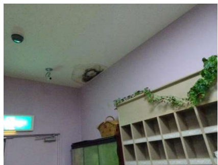
(山茶花高原香りの館 1 階天井漏水)
