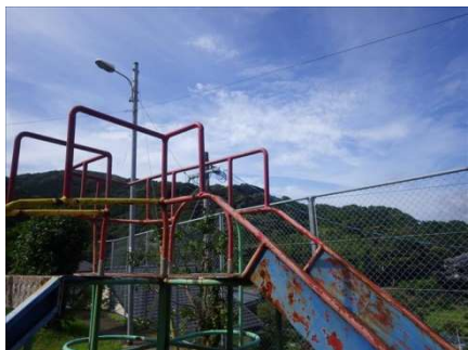
(小野団地公園滑り台腐食)
