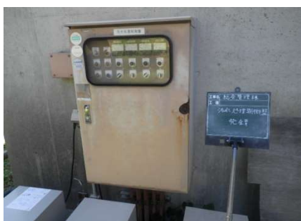
(白木峰高原総合管理棟制御盤発錆)
