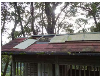
(久山城山公園便所屋根飛散)
