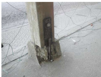
(白木峰高原直売所内部基礎 RC 欠損)
