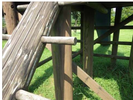
(山茶花高原複合遊具塗装劣化)
