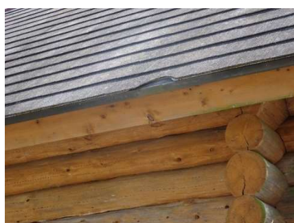
(白木峰高原管理事務所 1 屋根欠損)
