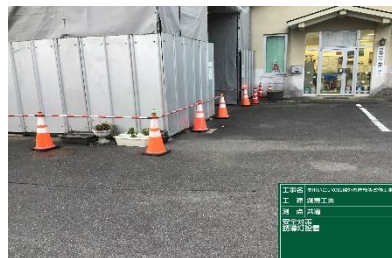
安全対策 （点滅誘導灯）
