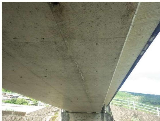
コンクリート桁のひびわれ
