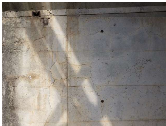
橋台躯体のひびわれ
