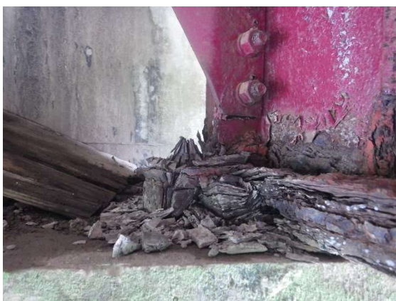
鋼製支承の腐食
