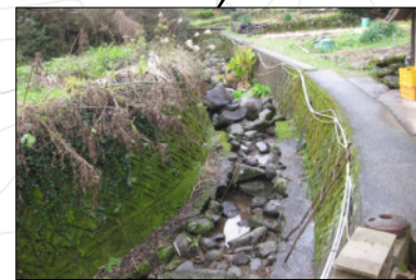
土石流の恐れ(大雨時)
