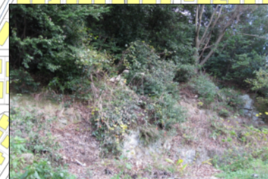
がけ崩れの恐れ(大雨時)
