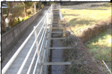
大雨時、水路があふれて避難できない
