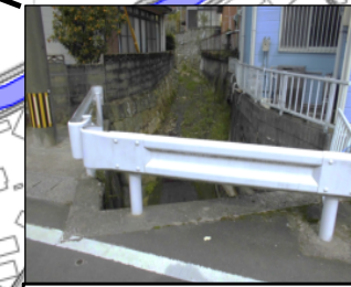
大雨時越水の恐れ
