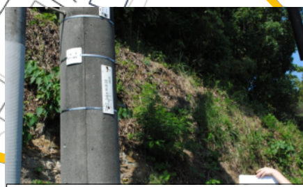
大雨時、崩壊注意
