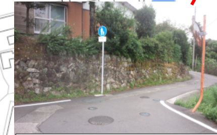
地震・大雨時、石積崩壊注意
