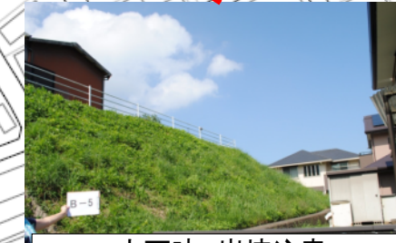
大雨時、崩壊注意
