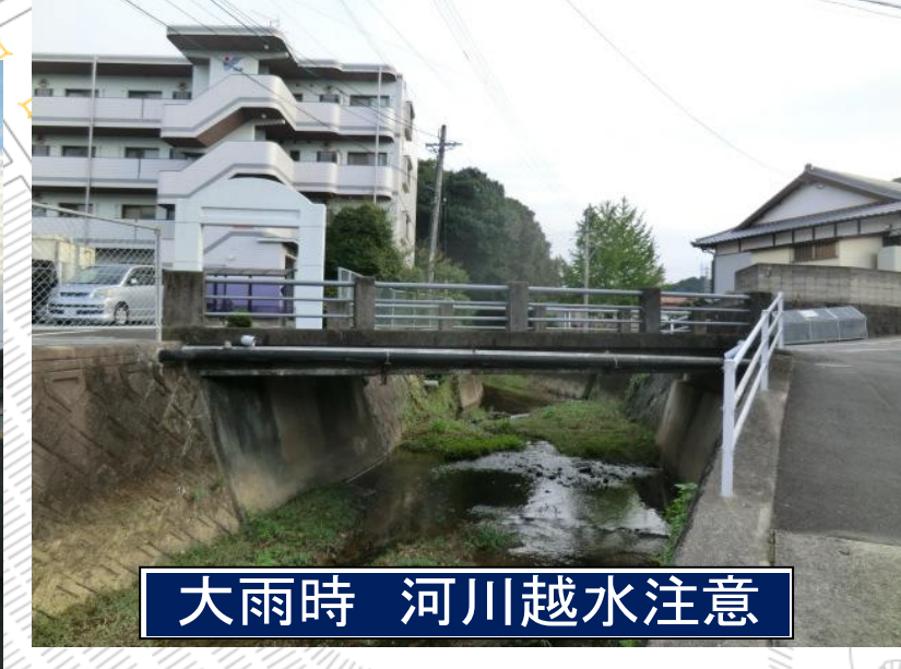
大雨時 河川越水注意
