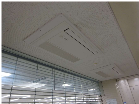
【空調機】令和6年度改修
