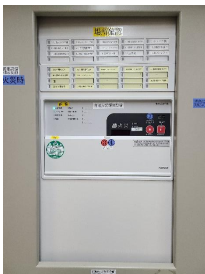
※火災報知設備（改修済）
