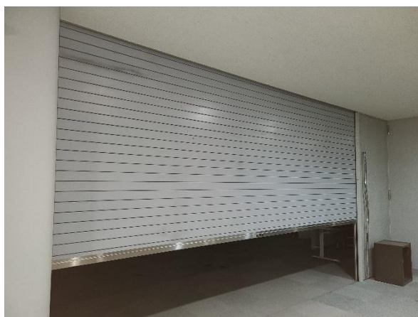
※防火シャッター
