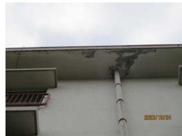
外部設備ボックス錆 (唐比東住宅)
