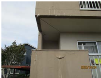
玄関扉・PB扉塗装の劣化 (永昌町住宅)
