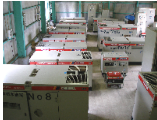
*可搬型の発電機
