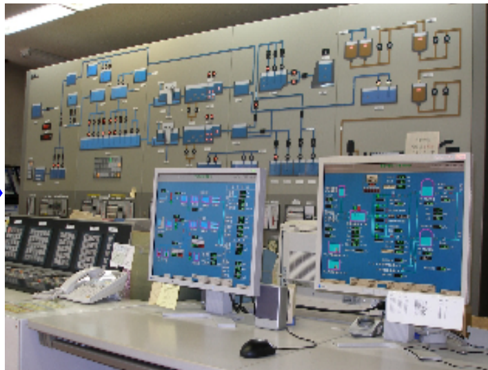
上水管理センターの中央監視装置。市内に点在する水道施設の運転状況などをここで集中監視できるよう整備します。
