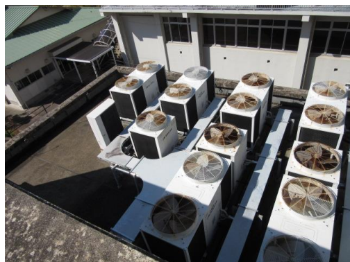
【1,2階部分室外機】
