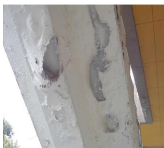
【外壁塗装剥がれ②】
