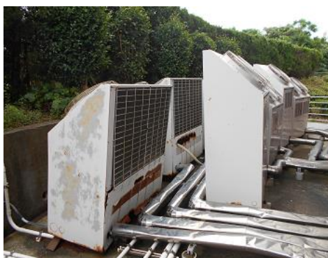
【空調機室外機】
