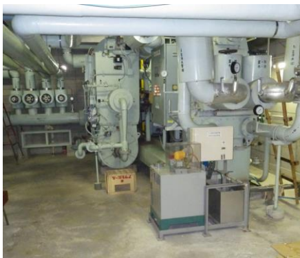
【空調設備熱源装置】
