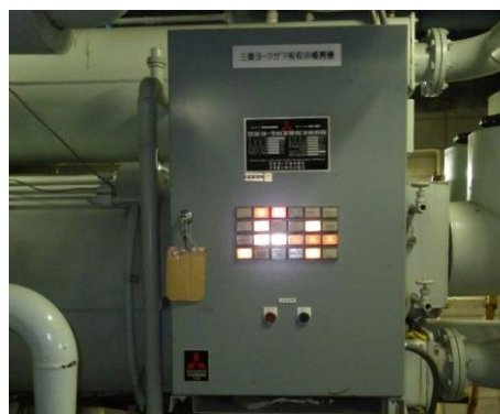
【空調設備基盤】
