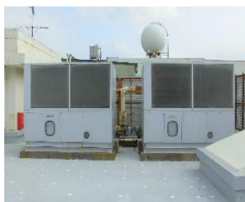
【空調機本体（全景）】
