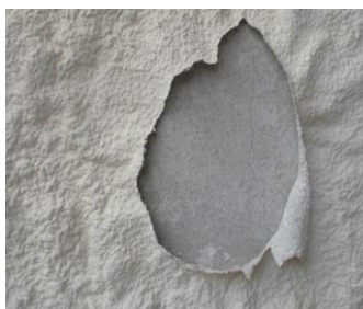
【外壁塗装剥がれ①】
