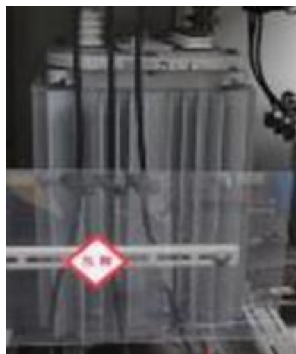
【電気設備（変圧器）】
