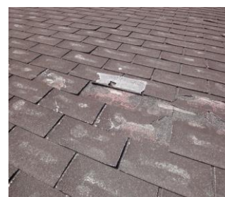
【屋上防水剥離】
