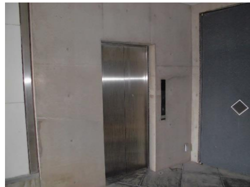
エレベーター
