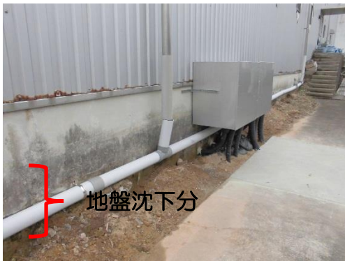
地盤沈下による配管等の露出
