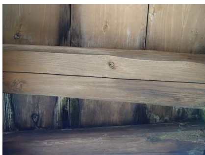
（屋根裏の浸水）
