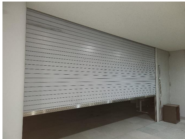
※防火シャッター
