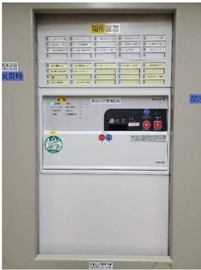
※火災報知設備（改修済）
