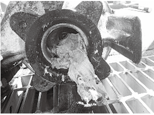
ポンプに詰まったお掃除シート
