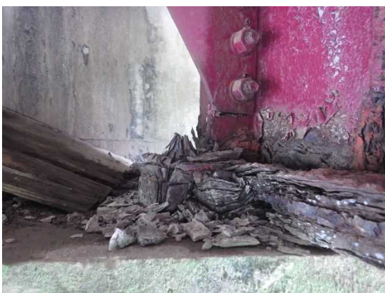
鋼製支承の腐食
