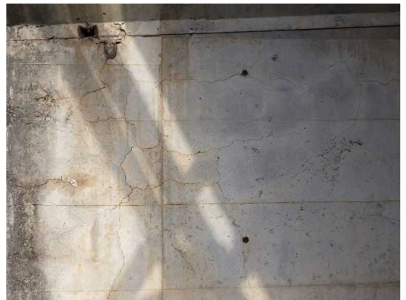
橋台躯体のひびわれ
