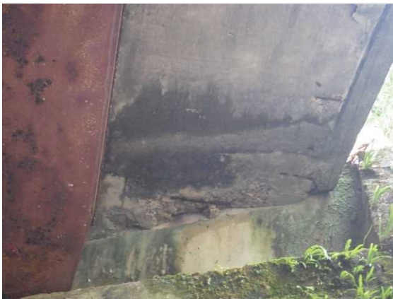
コンクリート床版の剥離・鉄筋露出
