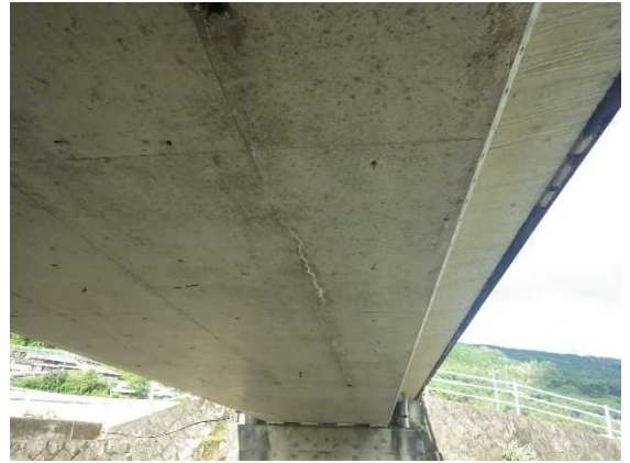
コンクリート桁のひびわれ
