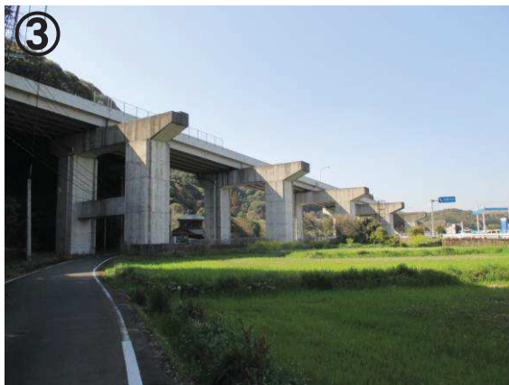
③ 橋梁下部工の現状（下大渡野町）
