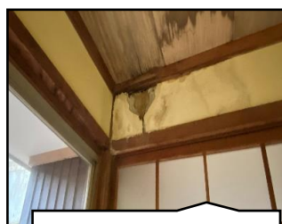
和室③雨漏り箇所
