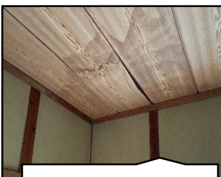
和室①雨漏り箇所
